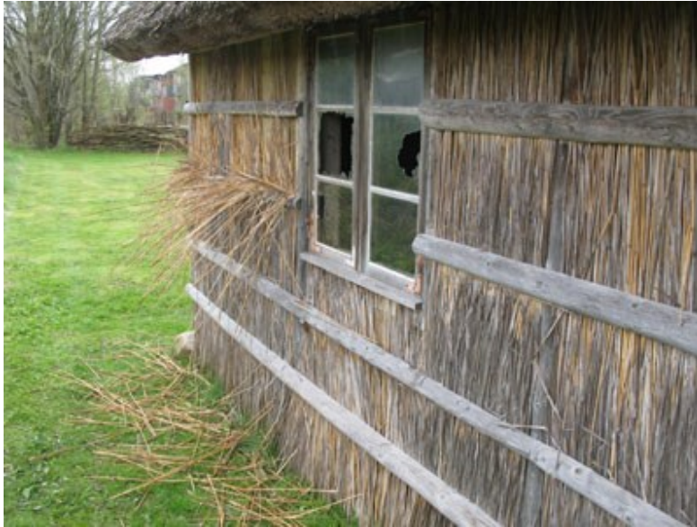
Hærværk på fårehuset ved husmandsstedet i Hillerød.
