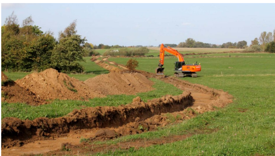
Et udsnit af den seks kilometer lange søgerende i forbindelse med nedgravning af fjernvarmeledninger.
