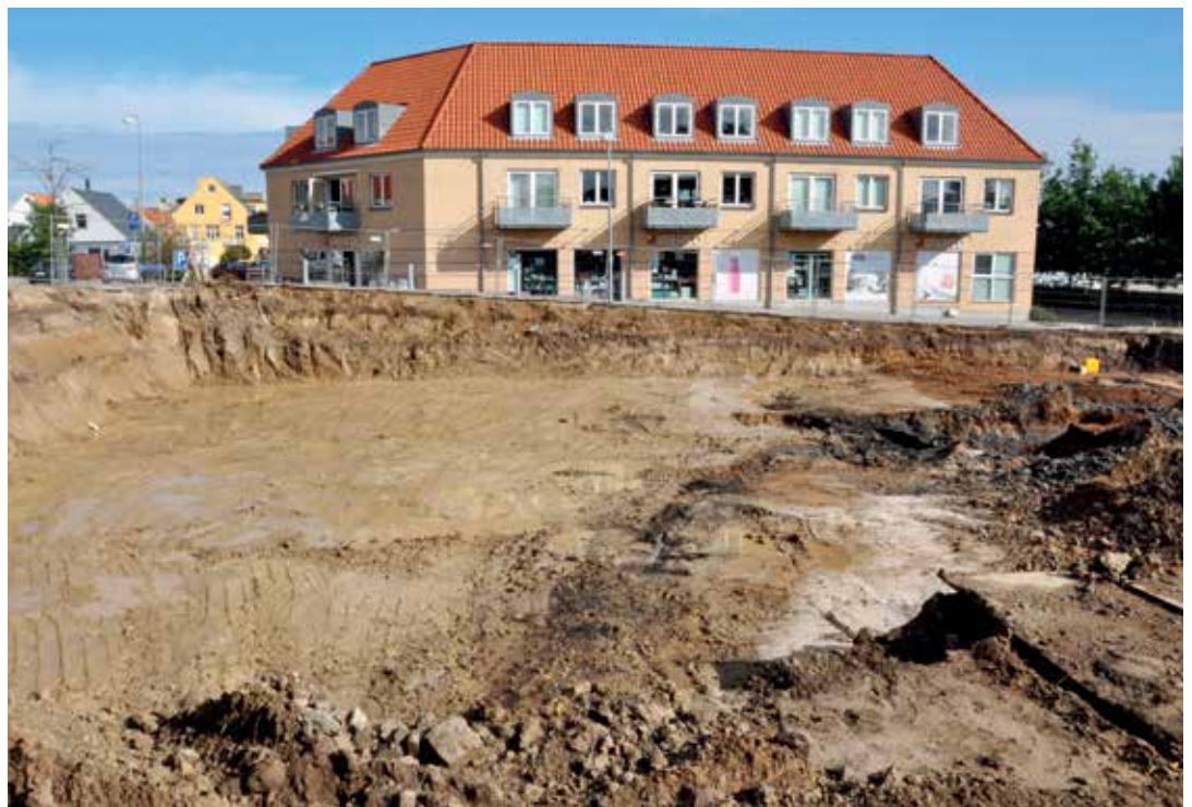
Udgravningen til fundamentet for butikkerne i Kulturhavn Gilleleje. Stenalderens kystlinje ses som en mørk stribe gennem fladen. T.v. for striben var der tørt land, t.h. ses sandaflejringerne på stenalderfjordens bund.
