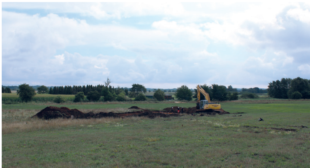
Udgravningsfeltet under afremning af overjord, set fra vest ud over Søborg Sø som anes i baggrunden.
